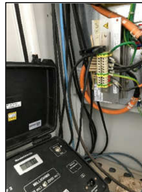
Continuidade (QD → Equip.)
