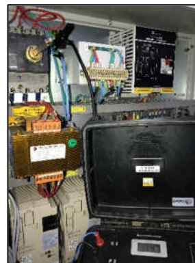
Continuidade (QD → Equip.)
