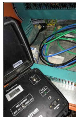
Continuidade (QD → Equip.)
