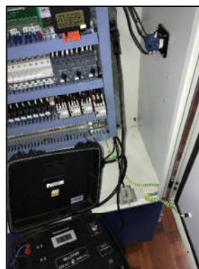
Continuidade (QD → Equip.)
