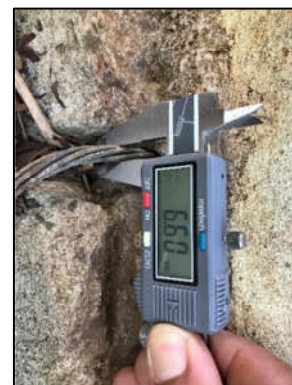
Fig. 7 – Diâmetro externo dos cabos de equipotencialização da subestação
