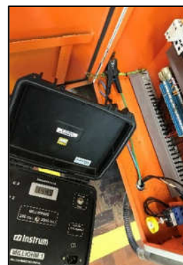
Continuidade (QD -> Equip.)
