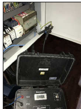
Continuidade (QD → Equip.)
