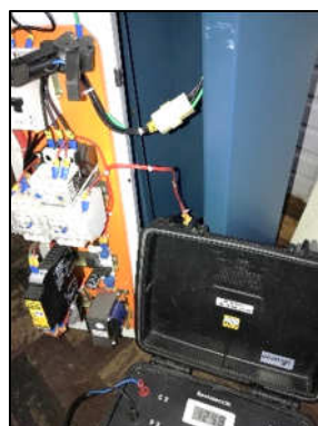
Continuidade (QD → Equip.)
