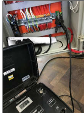
Continuidade (QD → Equip.)
