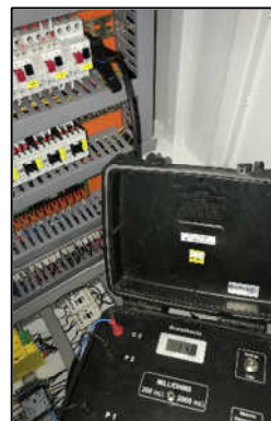
Continuidade (QD → Equip.)
