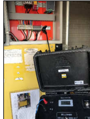
Continuidade (QD → Equip.)
