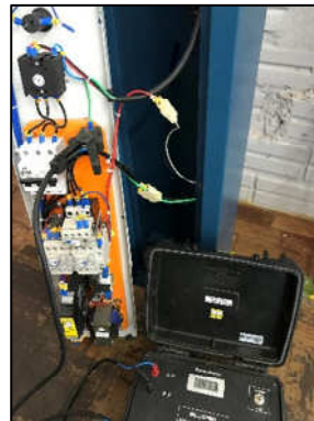
Continuidade (QD → Equip.)
