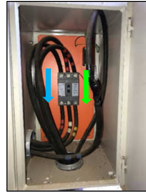
Fig. 4 – QG s/ barramento de N e PE
