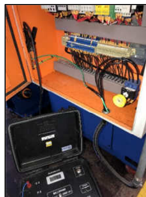
Continuidade (QD -> Equip.)
