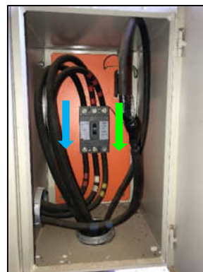
Fig. 4 – QG s/ barramento de N e PE
