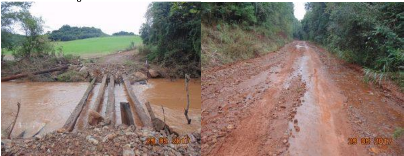
Figura 6 e 7. Pontes e estradas interditadas na zona rural
